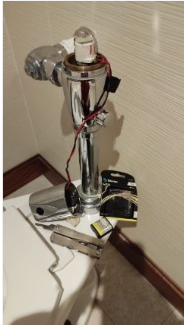
Revisión y cambio de baterías de WC
