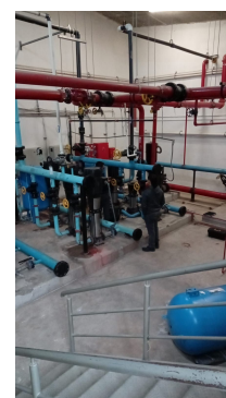
IHM en mantenimiento de hidroneumáticos mensual
