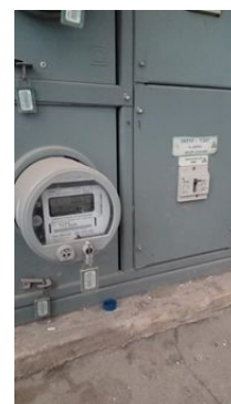
CFE cambiando software de medidores por cambio de horario en medición
