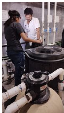
Hidromax en revisión y arranque de bomba de calor chapoteadero
