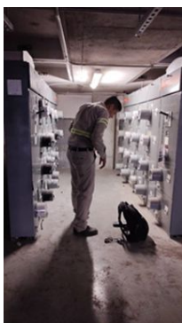
CFE toma de lecturas con problema de telemetría
