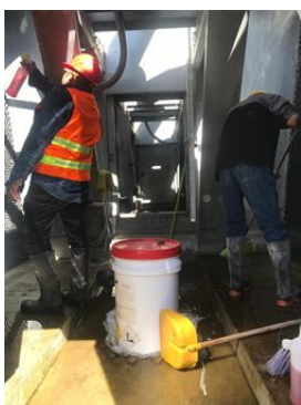
Limpieza de la T.E. #4 por prueba de mantenimiento
