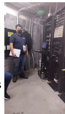
Neuroservice colocando la UP's en site de E5 para activación de cámaras
