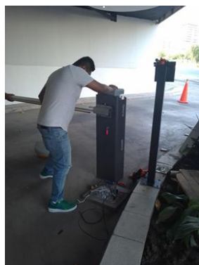
Desinstalación de pluma de residentes por proveedor, debido a daño por choque de residente
