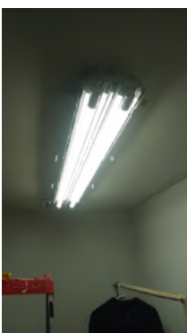
Cambio de iluminación en áreas de bodegas
