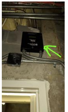
Limpieza y revisión de sistema de control de climas en east
