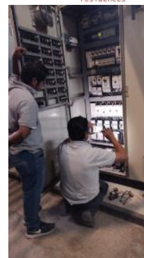
Personal de IPM en la revisión de tablero de control
