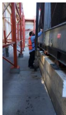
TQI en seguimiento a la calidad del agua de torres de enfriamiento
