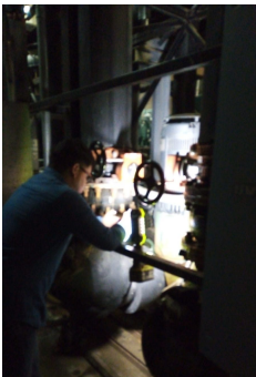
Revisión de variadores de velocidad de bombas primarias del chiller
