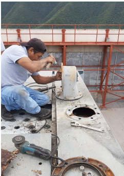
Se inicia mantenimiento a válvulas de torres de enfriamiento
