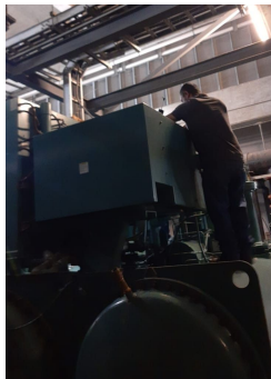
3GH en mantenimiento mensual a chiller's
