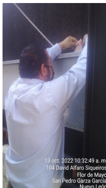
TQI en seguimiento a la calidad del agua de torres de enfriamiento
