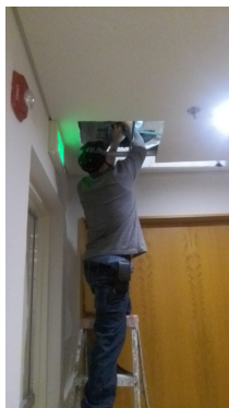
Reyno climas reparando provisional por fuga del 2204 que afecta al 2104 y GH4
