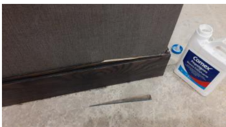
Instalación de zoclo desprendido en pasillo de elevadores
