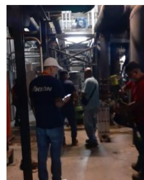
Personal de SISTEQ revisando bomba principal de 100 HP's
