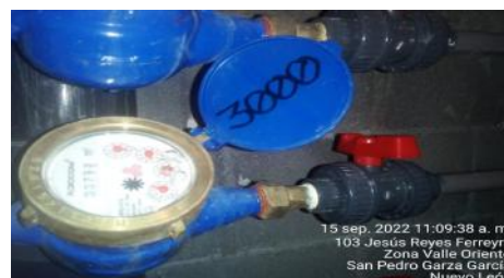
Apertura y cierre de los servicios de agua en edificios
