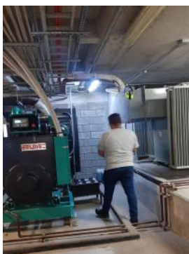
Personal de ISTESA en mantenimiento mensual a plantas de emergencia
