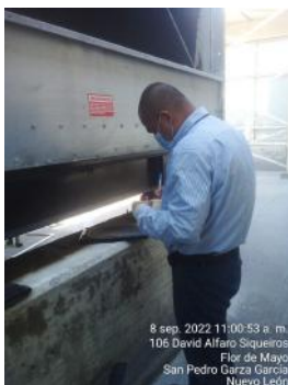
Personal de TQI en seguimiento calidad del agua en torres de enfriamiento
