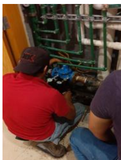
Proveedor IPM dando mantenimiento válvula reguladora del piso 30
