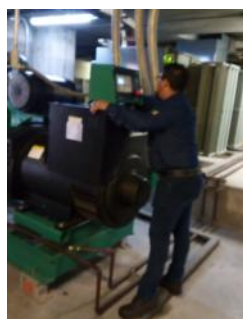
Personal de ITESA acude a plantas de emergencia mantenimiento mensual
