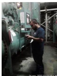
Personal de 3GH acude a chiller para mantenimiento mensual
