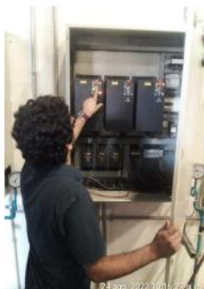
Personal de Ingeniería Hidroneumática mantenimiento mensual
