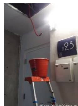
Drene de agua de charola de Fan Coil tapado
