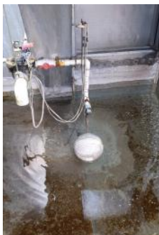
Ajuste de niveles de torre 4 de enfriamiento
