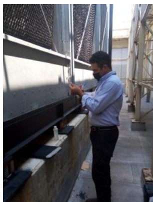
TQI en seguimiento a la calidad del agua de torres de enfriamiento.
