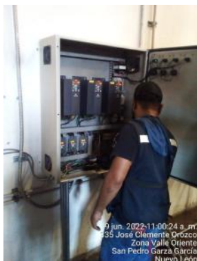
Revisión de variadores de velocidad de hidroneumático.
