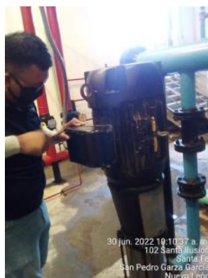
Ingeniería Hidroneumática en su mantenimiento mensual.
