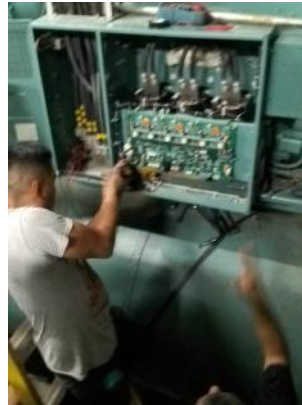
Personal de Fimser en seguimiento al diagnóstico de Chiller #2
