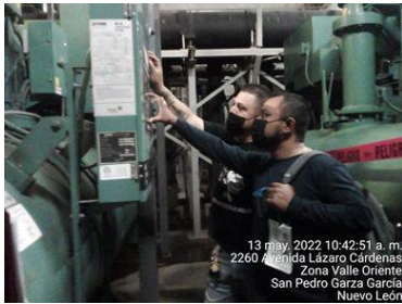
3GH en servicio mantenimiento preventivo mensual.
