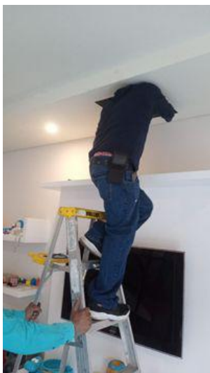
Revisión del fan coil de ludoteca por falla.
