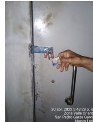
Se instala candado en área de chiller's para controlar el acceso al área.
