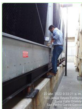
Personal de TQI en seguimiento a la calidad del agua del circuito abierto de chiller's
