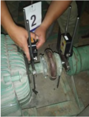
Alineación de motores de las bombas secundarias
