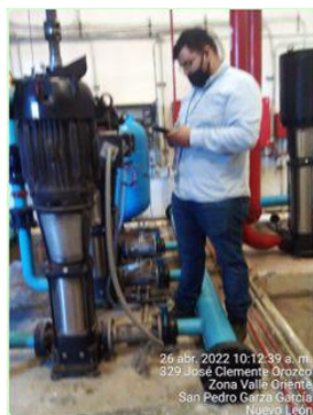
Mantenimiento preventivo mensual bombas de agua potable
