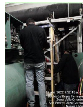
Se inicia mantenimiento del Chiller #2 por daño de fuga.
