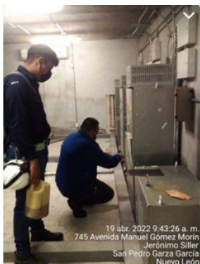
Personal de Mitsubishi en mantenimiento preventivo mensual
