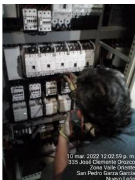
Bega armadora revisando los arrancadores que presentan falla por brida dañada
