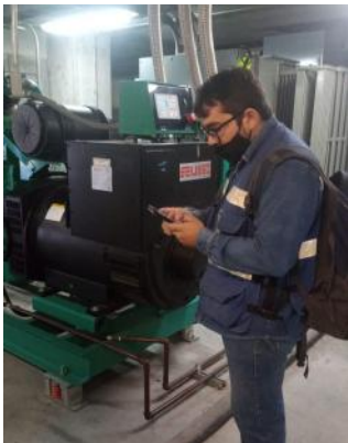
Personal de ISTESA para mantenimiento de plantas de emergencia
