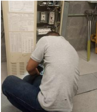
Revisión de elevadores de East
