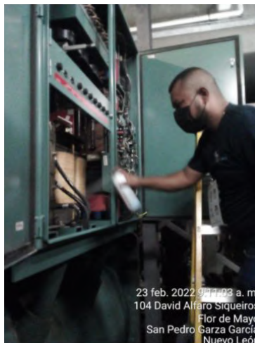
Atención a falla del chiller 1 por ruptura de brida de las bombas secundarias.
