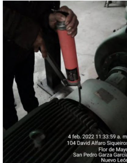
Lubricación a motores de bombas secundarias
