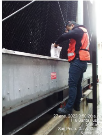
Personal de TQI para seguimiento a la calidad del agua en torres de enfriamiento.
