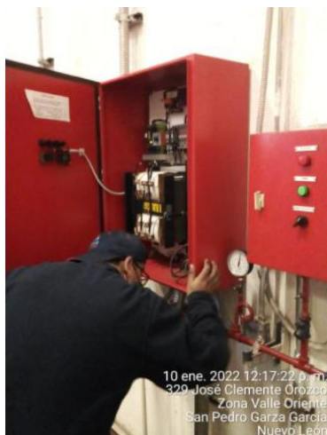
Revisión mensual del panel de control del sistema contra incendios
