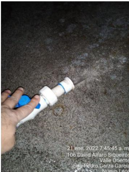
Se monitorea calidad del agua y continuamos con purga en las torres de enfriamiento.
