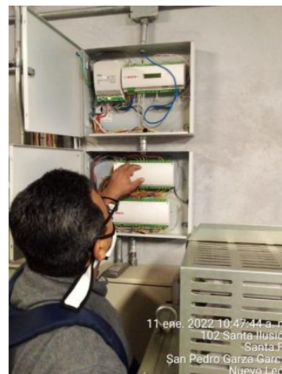
Revisión de falla de control de acceso en elevador 2 de Torre West.
