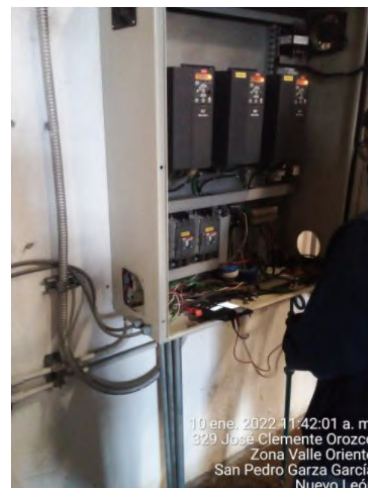
revisión de sistema de control del bombeo media y alta presión
