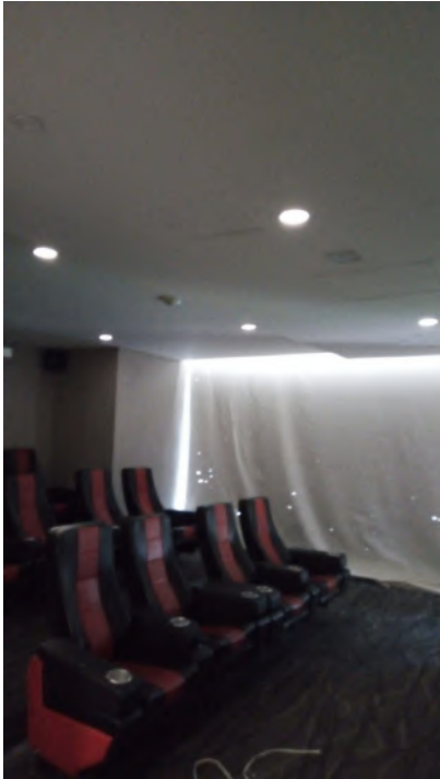
Cambio de iluminación con control de intensidad en sala de cine
