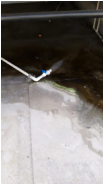
Purga al sistema de torres de enfriamiento derivado de los análisis físico, químico y de limpieza mecánica.
