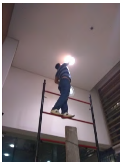
Cambio de tipo de luminarias con mejor intensidad lumínica
