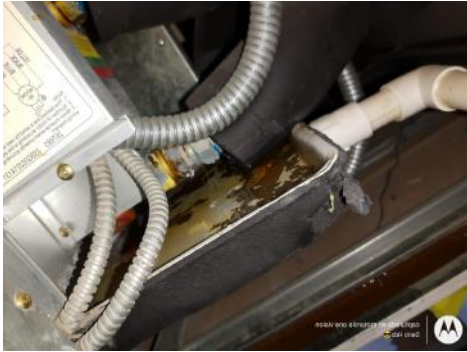
Limpieza de Charolas de condensación.
