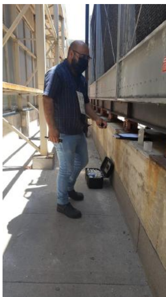
Visita preventiva y de mantenimiento a Torre de enfriamiento por TQI.
