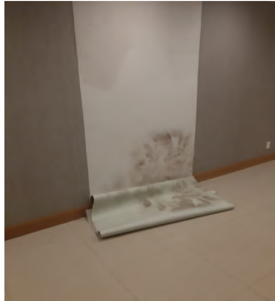
Se desprende tapiz de piso 15 torre West y se procede a solicitar cotizacion de tapices, reparacion de muro con humedad,
