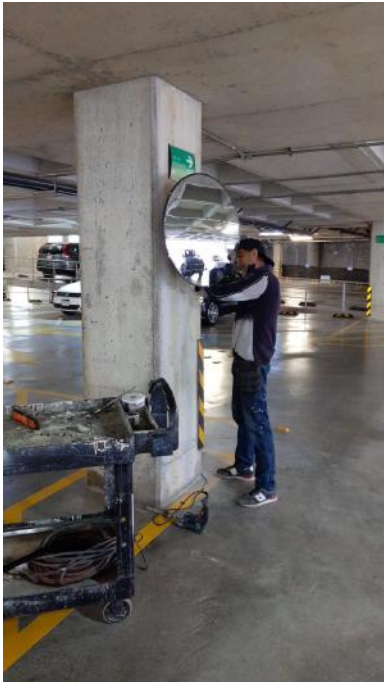
Se coloca espejo convexo en área de estacionamiento.
