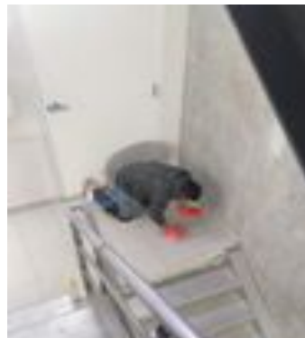
Limpeza de pisos de área de cubo de escaleras de torre West y East.
