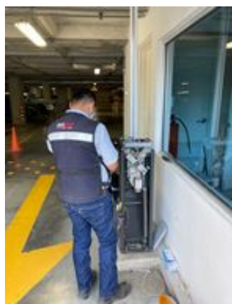
Mantenimiento de control de acceso en barreras de estacionamiento.
