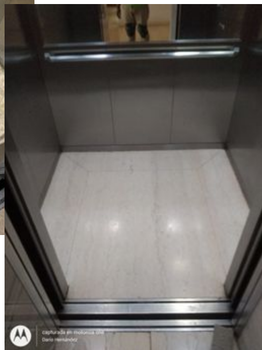
Limpieza de piso de mármol en las 6 cabinas de elevadores con químico especial tizate.
