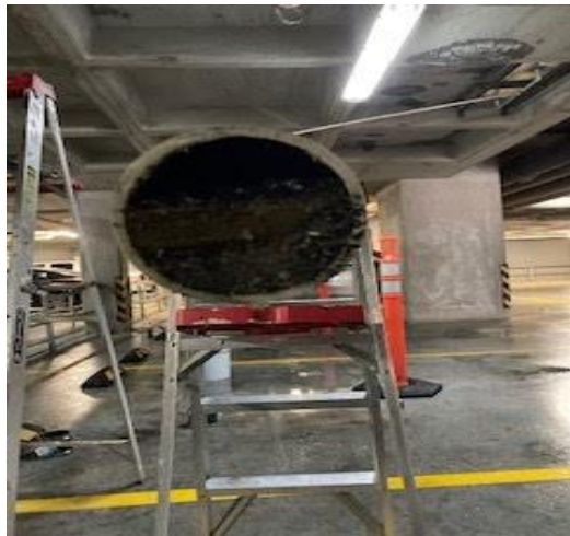
Reparación de tubería pluvial de 4" debido a que se encontraba tapada por residuos en estacionamiento 1.
