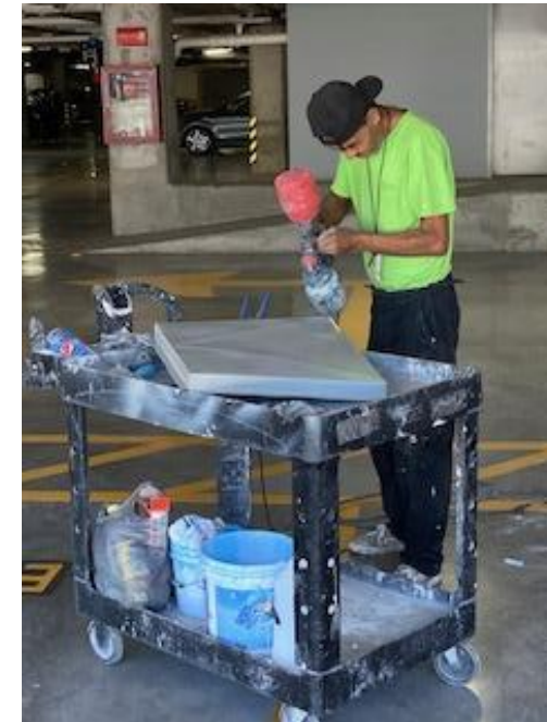
Instalación de charola de protección de goteo de tubería pluvial en Estacionamiento 1.
