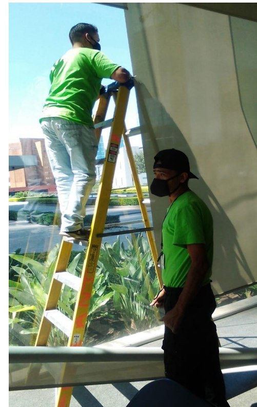
Se realizó instalación de persiana en Gym East debido a que se desprendió.
